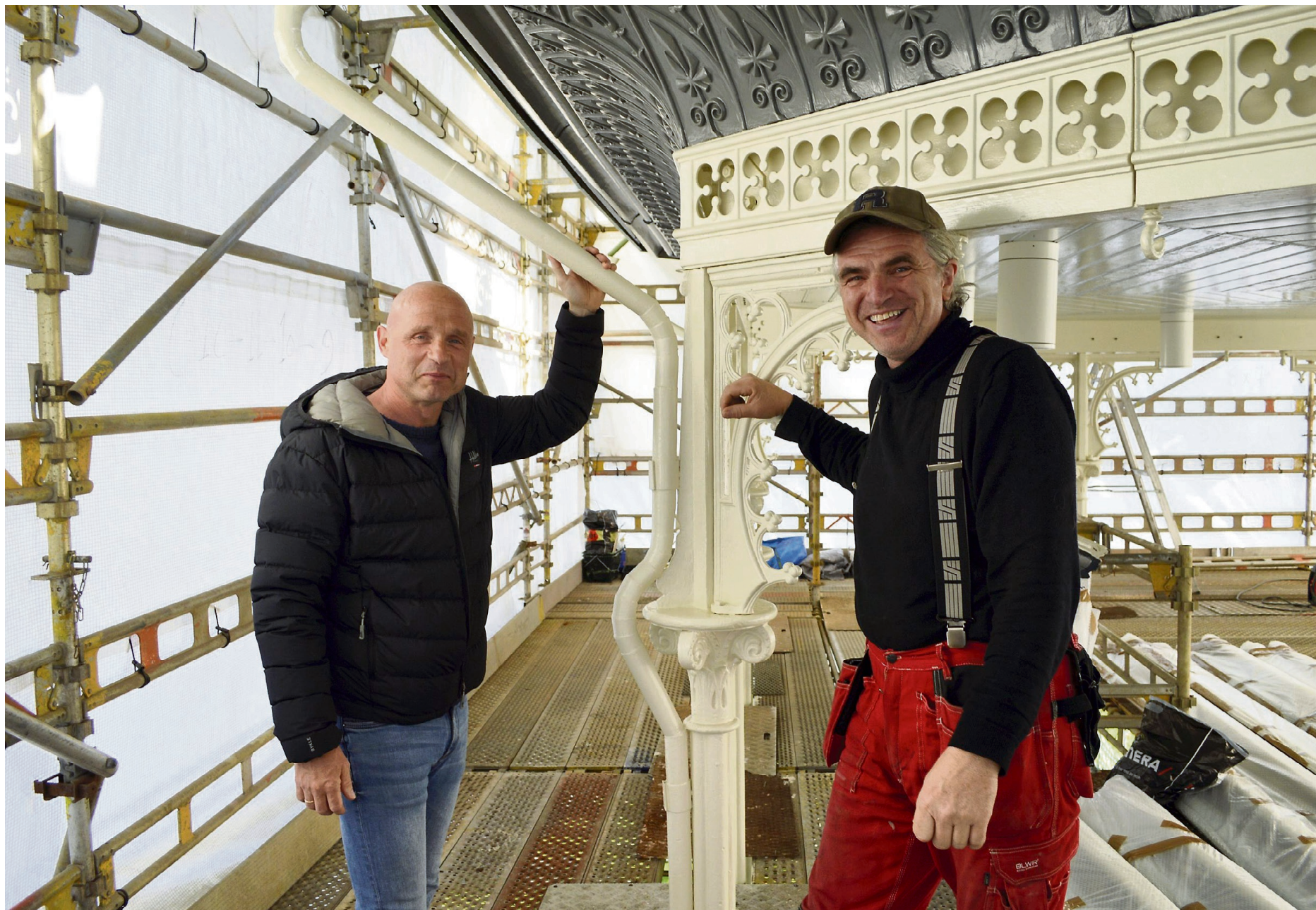
SAMARBEID: Prosjektlederen og ildsjelen – Trond Torvund (t.v.) og Roger Iversen er begge veldig fornøyd med jobben som nå snart er gjort. Nå gjenstår litt montering av rekkverk og lister og så kastes plasten av stillaset fra kommende mandag.
