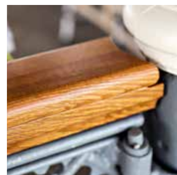
NYTT: Råtne deler som armgangene på rekkverket, er erstattet med nye tro kopier.
